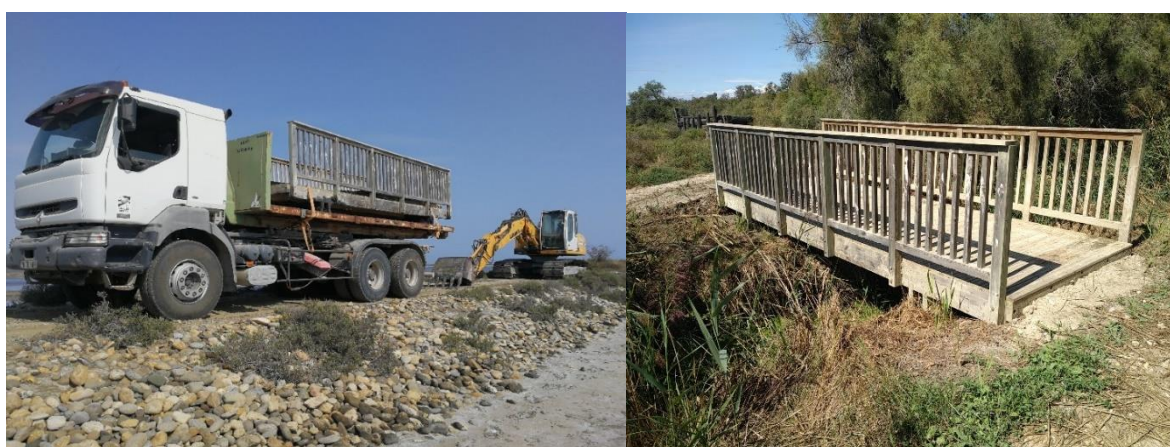
Illustration 13 : Transport et installation de la passerelle au Domaine de la Palissade ©P.Rigaud, 2022.
