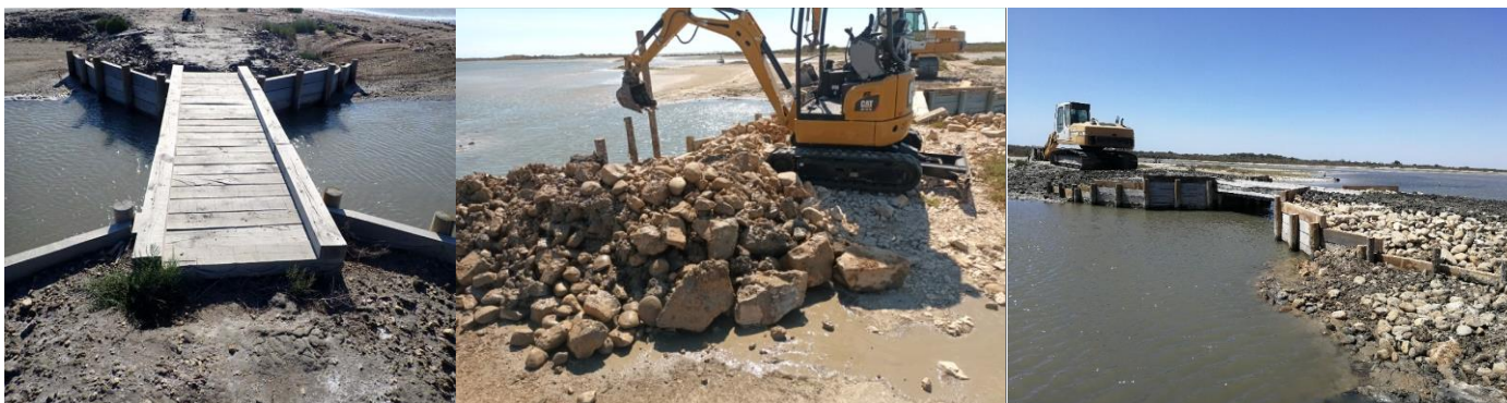
Illustration 10 : Cayrelles et confortement ailes des ouvertures libres ©P.Rigaud, 2022.
